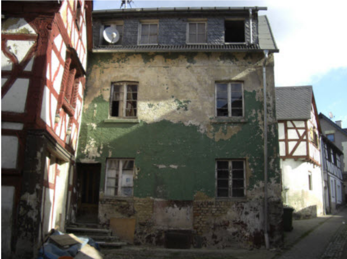
Das einsturzgefährdete baufällige Wohnhaus neben der Unteren Mühle.
